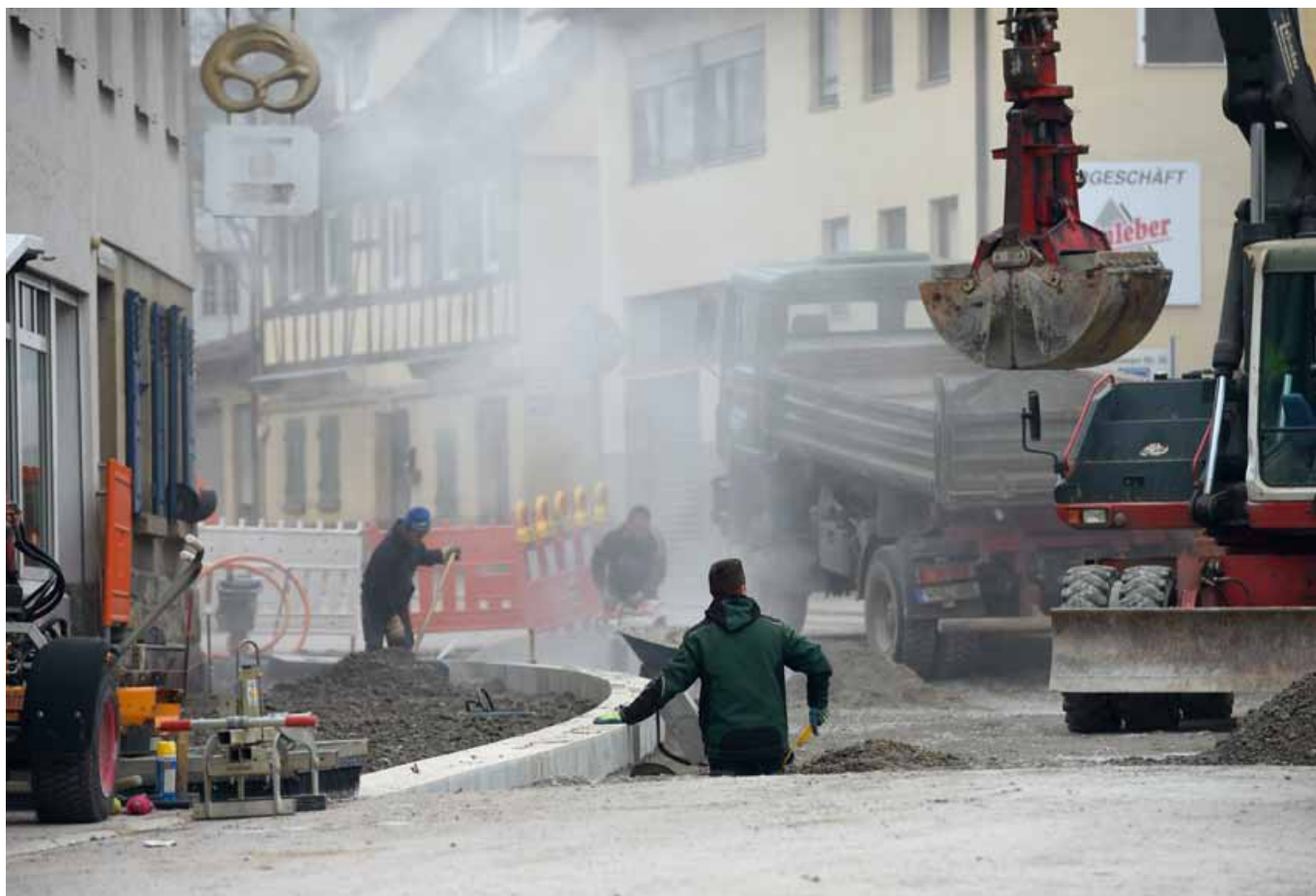
Fast 500 Meter der Landstraße 1080 sind in den vergangenen Monaten umgebaut worden, statt des üblichen grauen Asphalts wurden Pflastersteine verlegt.
